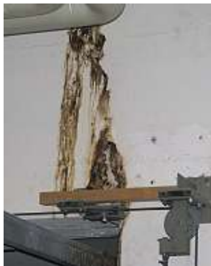
Spuren der Baumängel sind im gesamten Turnhallen-Areal zu finden.
